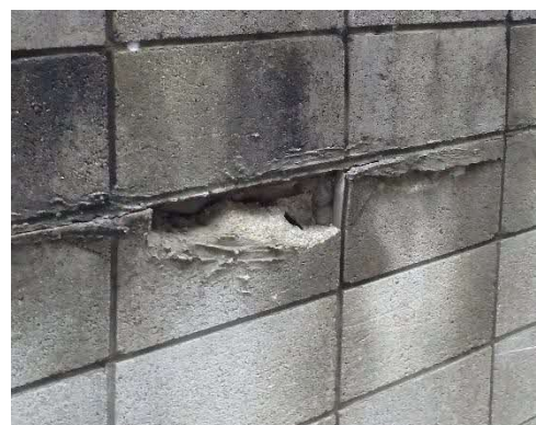
危険なひび割れ、かけ
