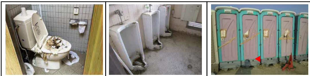
▲災害時の水洗機能を失ったトイレ
