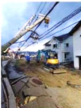
石川県輪島市 国道249号
