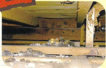
天井裏のフン被害
