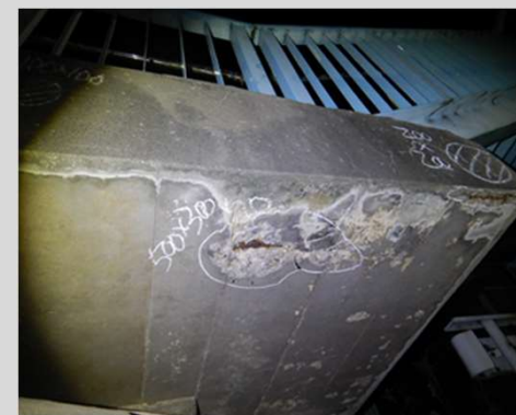
コンクリートの損傷
