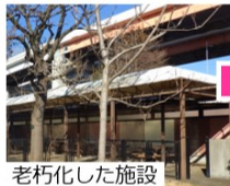
老朽化した施設
