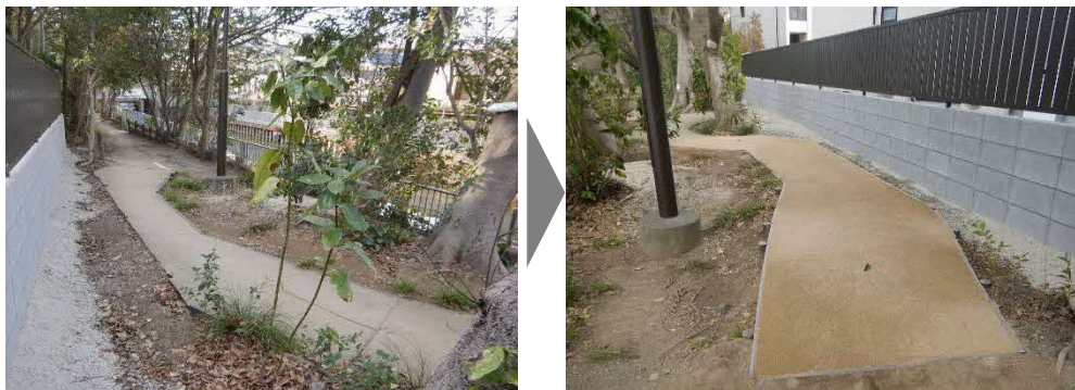
根上がり対策で舗装による補修を行った例 (神明六木遊歩道)
