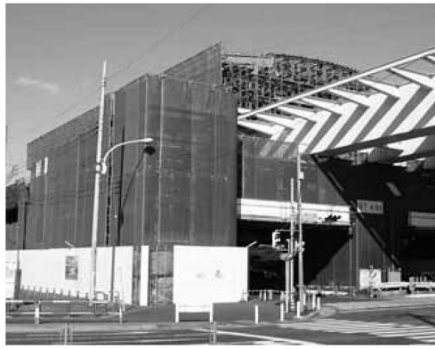
▲駅舎工事・けた工事が進む舎人公園駅(仮称)。ほかの駅も順調に工事が進んでいます
