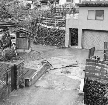
▲浸水や土砂崩れの被害が相次いだ「平成20年8月豪雨」(八王子市提供)
