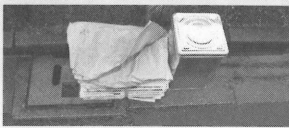
▲雨水は「雨水ます」から下水道管に流れます。写真のように上に物を置いたりゴミを入れないでください
