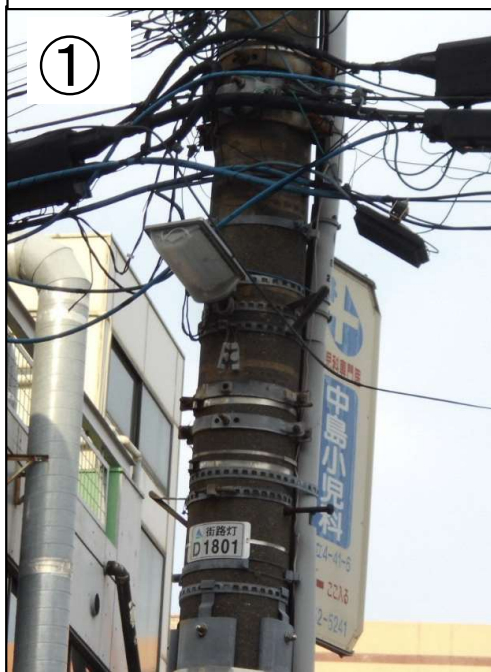
電柱に設置している 街路灯（区所有）
