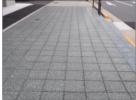
雨水流出抑制施設（透水性舗装） （千住大橋駅前のかつら並木通り）
