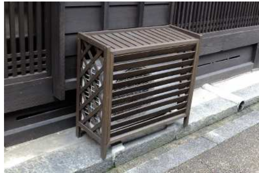
建物の足元のエアコン室外機を木格子風のカバーで目隠ししている例
