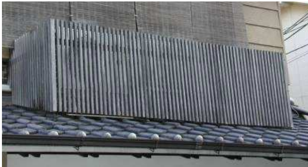
底に設置されたエアコンの室外機を木格子製のカバーで目隠ししている例
