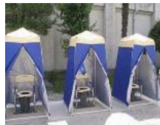
マンホールトイレ
