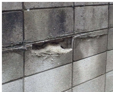
危険なひび割れ、かけ
