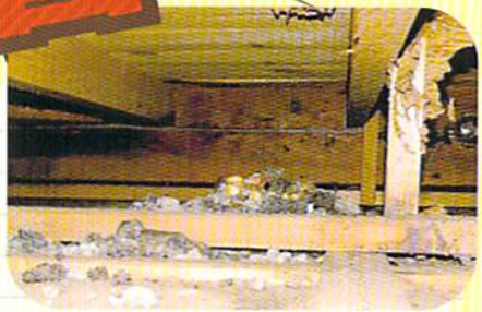
天井裏のフン被害
