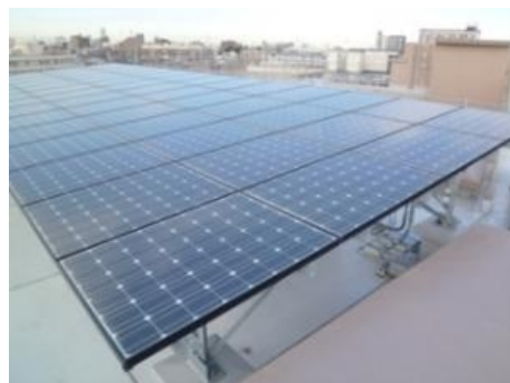
西新井小学校の太陽光発電装置
