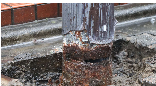
※腐食の状態（街路灯根元部分）
