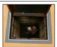
消火栓蓋を開けた状態
