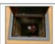
消火栓蓋を開けた状態
