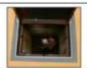
消火栓蓋を開けた状態
