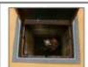
消火栓蓋を開けた状態
