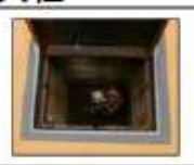
消火栓蓋を開けた状態
