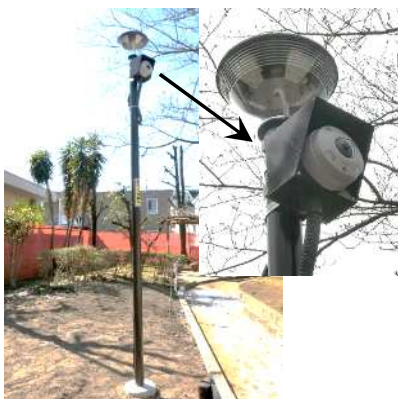
防犯カメラの設置
