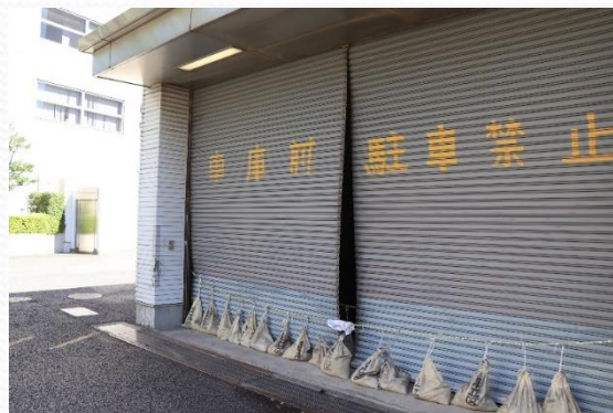
シャッター破損(区役所本庁舎車庫)
