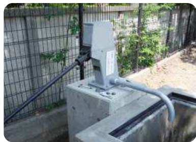
関屋公園防災井戸
