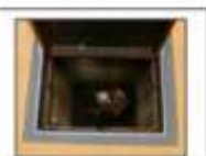
消火栓蓋を開けた状態
