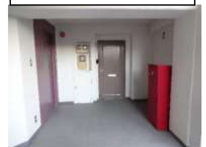
消火器 (エレベーター前)
